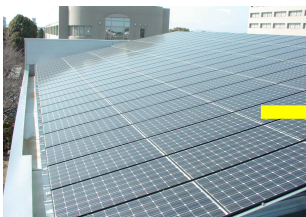
屋根(太陽光パネル)で発電
