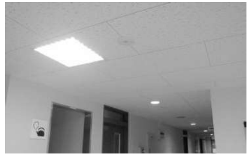
廊下 LED照明
