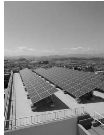
太陽光発電設備80kW
