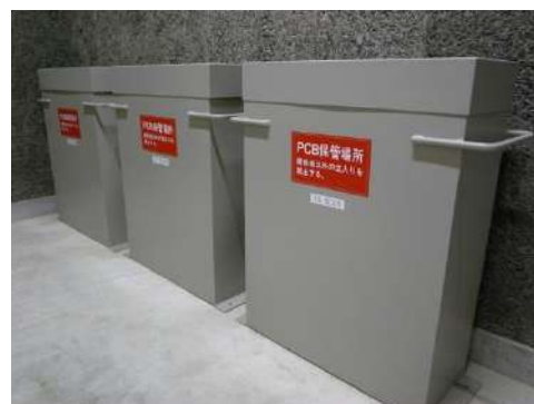
PCB保管状況
