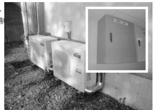
高効率空調室外機とデマンドコントローラー装置
