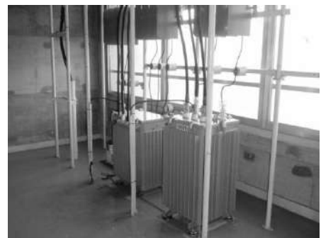
高効率高圧変圧器
