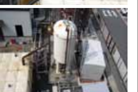
川根温泉メタン発電施設
