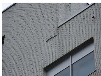
外壁タイル浮きによる剥落
