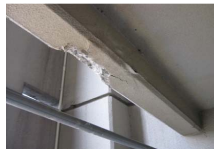
コンクリートの剥落
