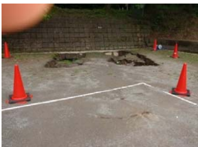
屋外排水管の漏水による バレーボールコート陥没
