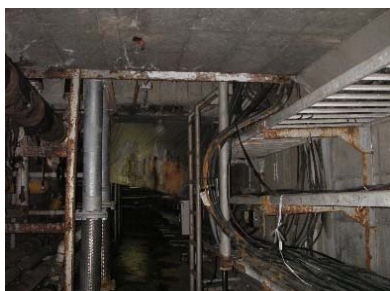
ライフラインの老朽化 (共同溝内)
