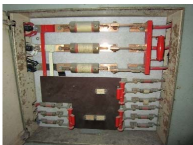
充電部分が露出した 分電盤（感電の恐れ）
