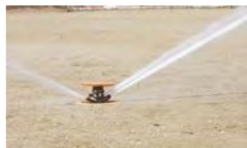
島田中 プール水再利用散水設備
