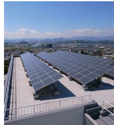
共通教育A棟 太陽光発電設備80kw
