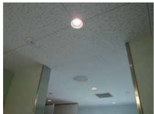
トイレ人感センサーによるLEDダウンライト
