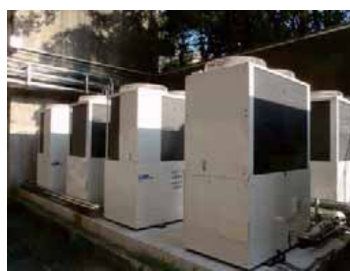
ガス式ヒートポンプ型空調室外機
