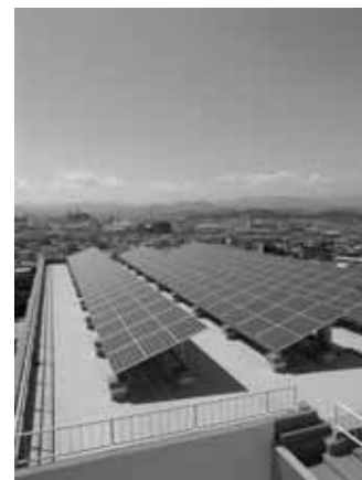
太陽光発電設備80kW ( )は、売電電力量を示す。
