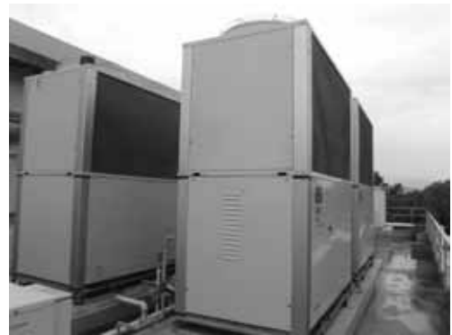
ガス式ヒートポンプ型空調室外機 （Wマルチ）
