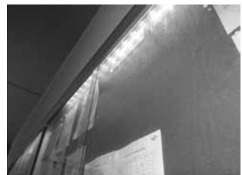
掲示板LED型照明設備
