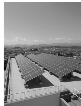
太陽光発電設備80kW
