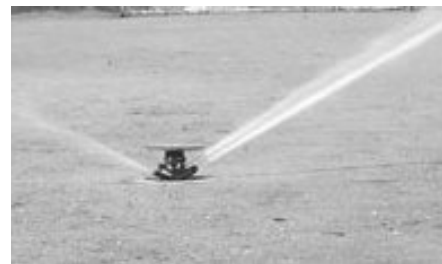
附属島田中学校 プール水再利用散水設備
