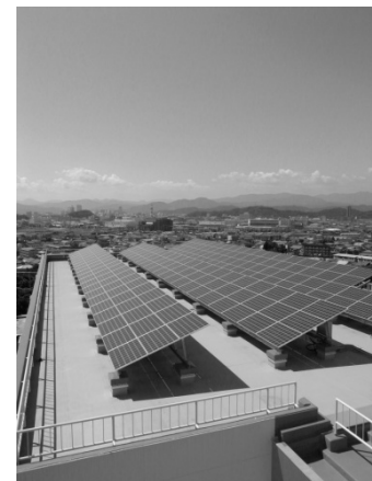
太陽光発電設備80kW ( )は、売電電力量を示す。
