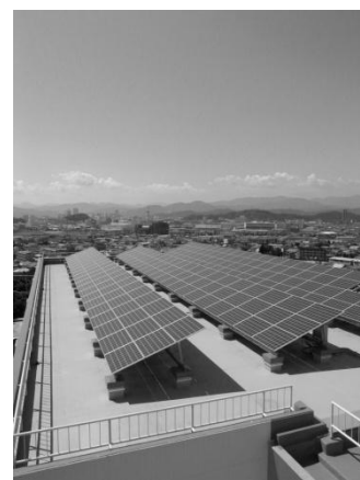
太陽光発電設備80kW
