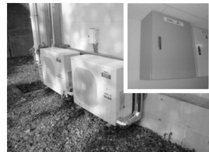
高効率空調室外機とデマンドコントローラー装置
