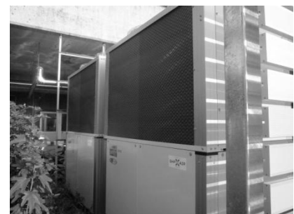
ガス式ヒートポンプ型空調設備（Wマルチ）
