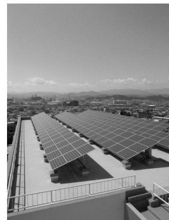
太陽光発電設備 80kW
