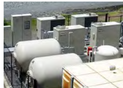
図2.静岡県島田市の川根温泉メタンガス発電施設
