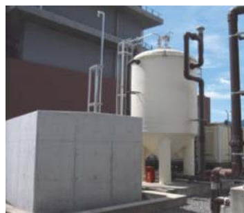
メタン分離槽
