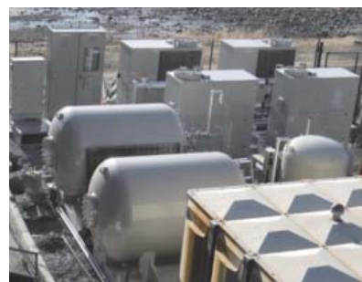
ガスホルダーとガスエンジン発電機
